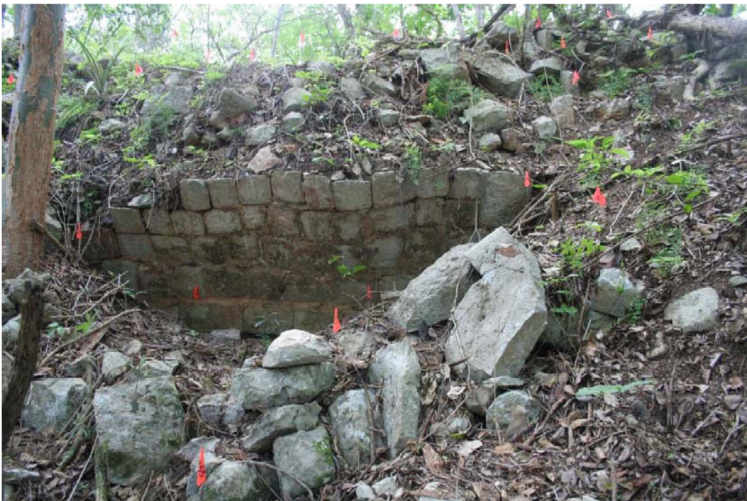
Figura 2-17. Cuarto colapsado (Cuarto 3), Estr. N5245E4820, Grupo Maler (IMG_4115)
