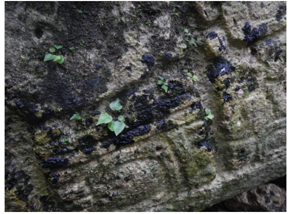
Figura 14.25. Detalle del lateral derecho que presenta los problemas de microorganismos. Foto Juan Carlos Pérez.
