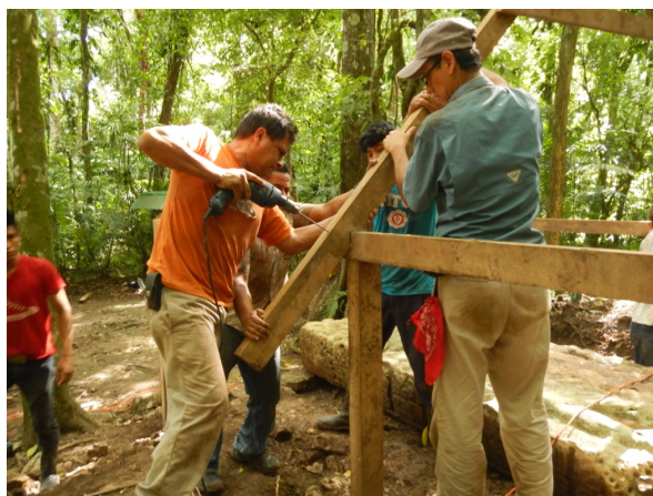
Figura 14.10. Ensamble de la armazón de madera de pucté para la cubierta de la Estela 39. Foto Griselda Pérez.
