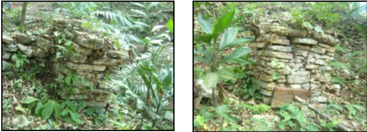
Fig. 17.35. Condición estructural de la Columna 3 del Edificio J-6, mantenida en pie por una serie de raíces que la detienen.
