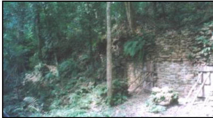
Fig. 17.39. Estado de deterioro de las columnas frente a J-6 y J-7, previo a las intervenciones de consolidación.
