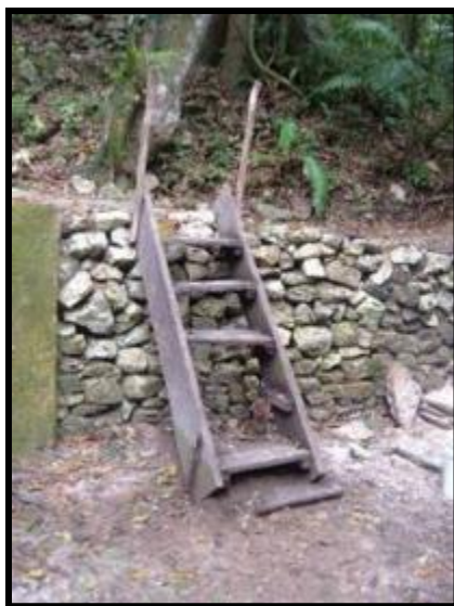
Fig. 17.41. Acceso 1, colocado junto a las lápidas de la escalinata megalítica, muestra deterioro y pérdida de los peldaños.
