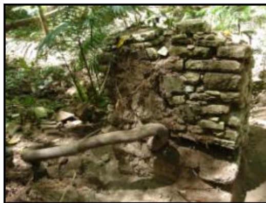
Fig.17.36. Proceso de limpieza de la Columna 3, muestra la grandes raíces que deterioraron su estructura.
