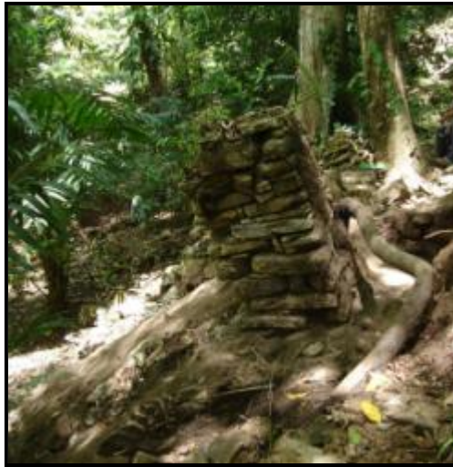
Fig. 17.37. Columna 3, con inclinación hacia afuera, colapso provocado por raíces de los árboles.
