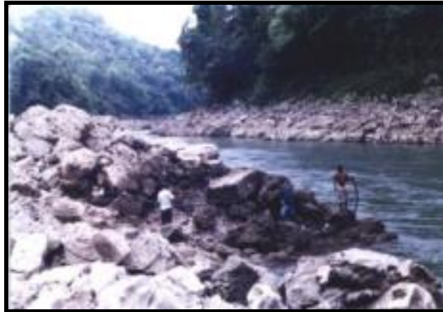
Fig. 17.10. Colocación del poliducto para subir agua hacia la plaza del Grupo Oeste, para trabajos de consolidación.
