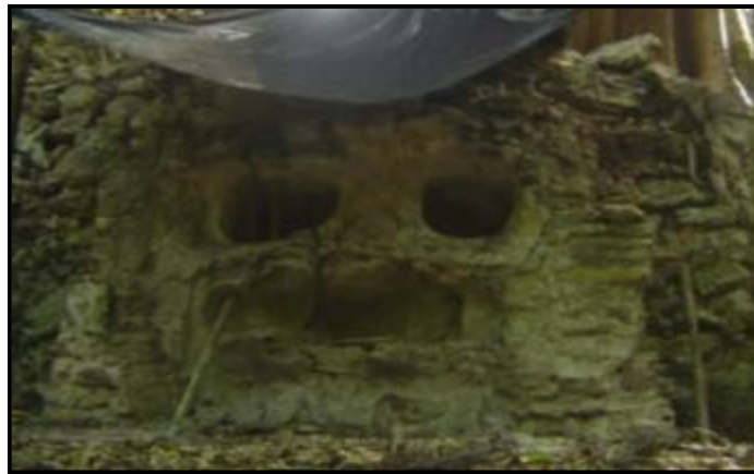
Fig. 17.29. Condición estructural del Mascarón del Edificio k-5 hasta junio del 2007.
