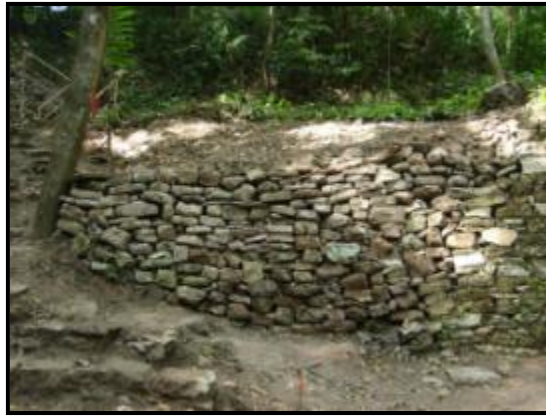
Fig. 17.21. Muro de contención colocado para rellenar la trinchera de la plataforma que conduce a J-7
