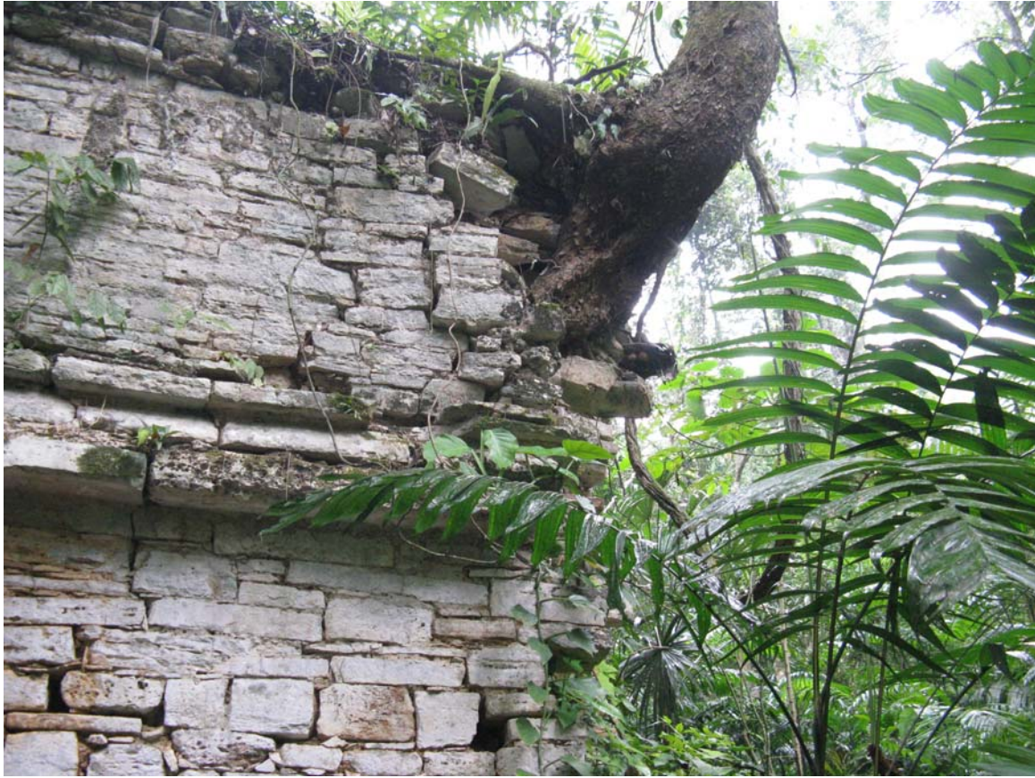
Figura17.4. Severidad de los daños ocasionados por el crecimiento de vegetación y filtración de raíces en los muros del Edificio D3-1.
