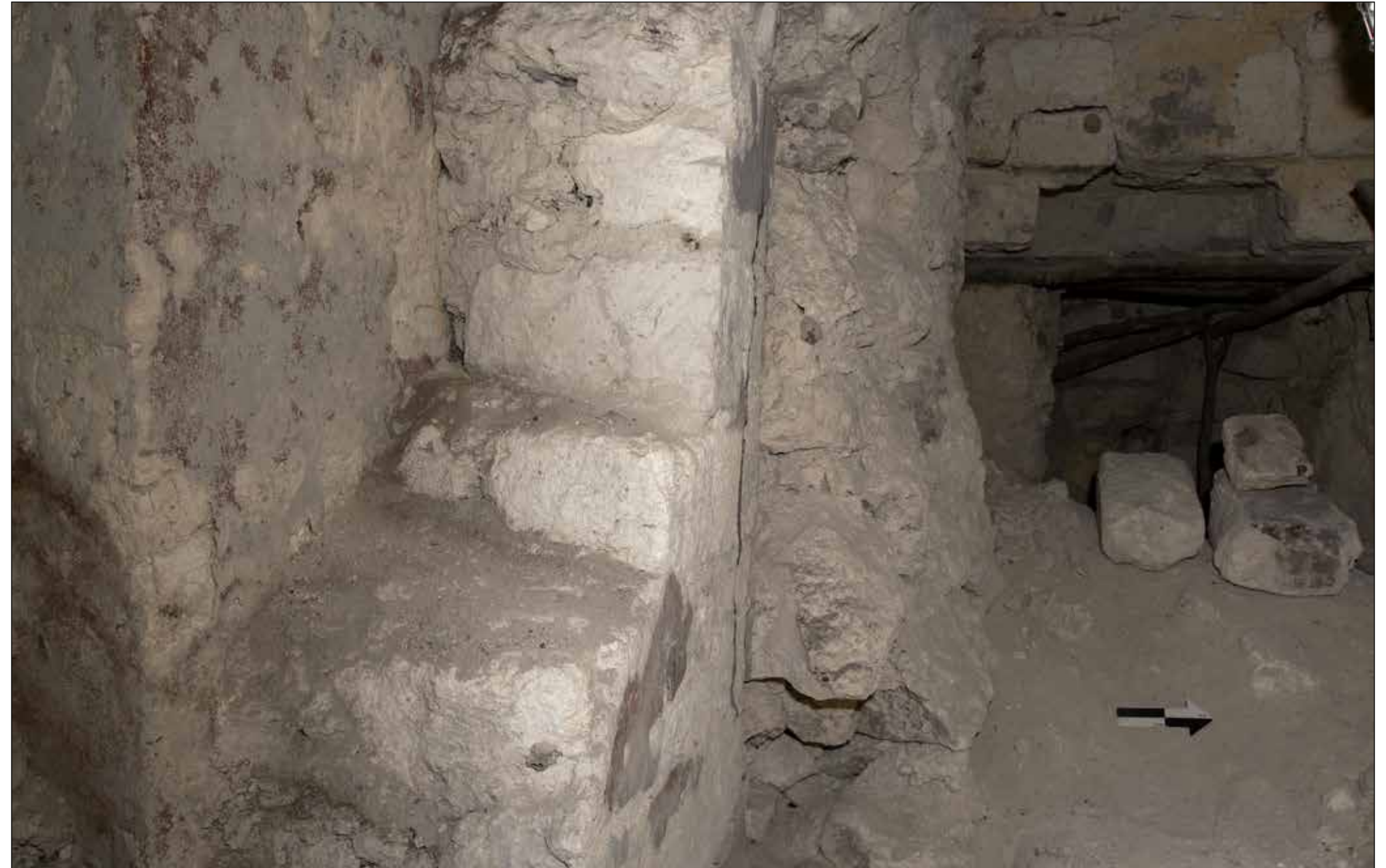
Figura 2.30. Cámara frontal del Templo del Sol Nocturno, reforzada mediante un engrosamiento de la jamba de su muro medio para contrarrestar fallas estructurales. Foto: Arturo Godoy.
