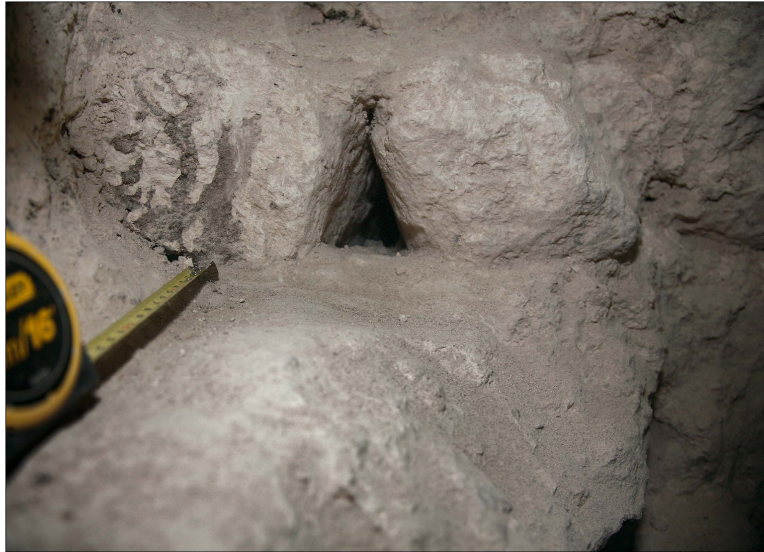
Figura 2.24. Pequeña cavidad triangular sobre la bóveda de la tumba, que pudo haber servido como "psicoducto" que permitía tener contacto con el difunto enterrado abajo. Foto: Stephen Houston.
