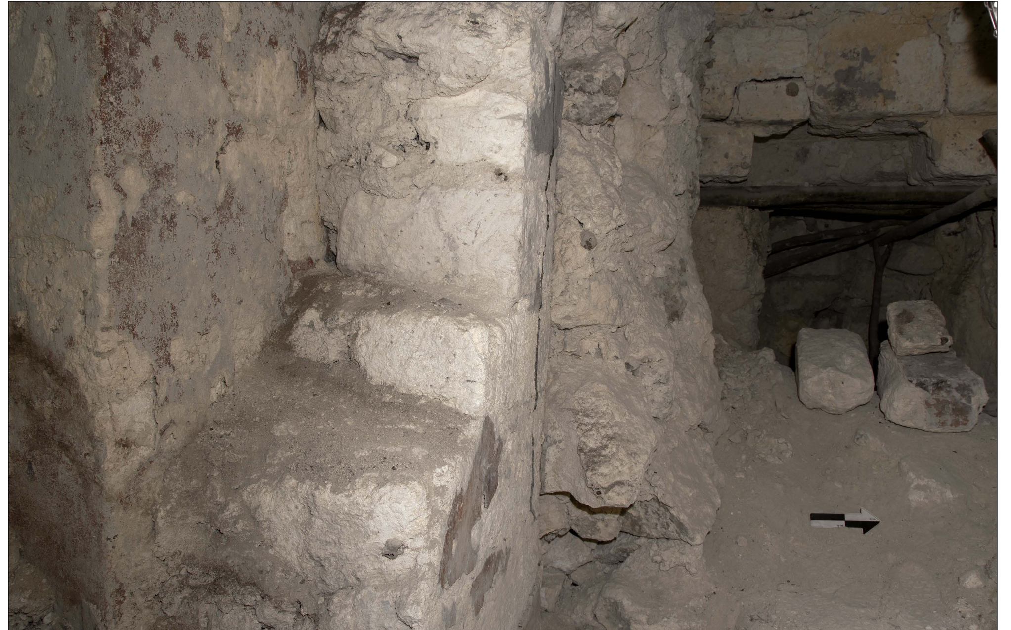
Figura 2.30. Cámara frontal del Templo del Sol Nocturno, reforzada mediante un engrosamiento de la jamba de su muro medio para contrarrestar fallas estructurales. Foto: Arturo Godoy.
