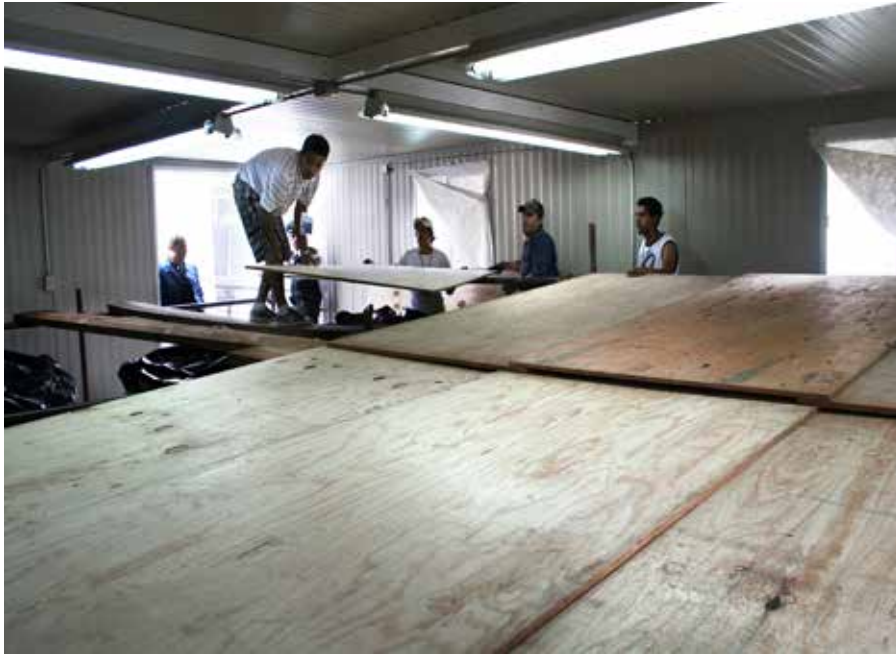
FIGURA 165. Tablones de madera de pino y hojas de triplay sobre la estructura tubular (FCM).
