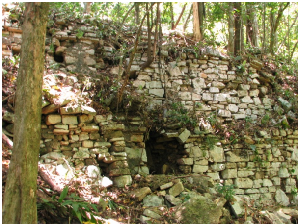
Fig. 12. Frente Norte del “edificio Maler” con la falla estructural en correspondencia de la etapa de ampliación (foto Esteban Mirón)
