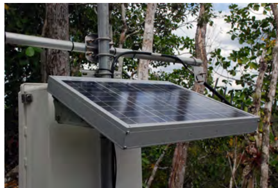
Figura 8.1.18. Panel Solar, Estación 3
