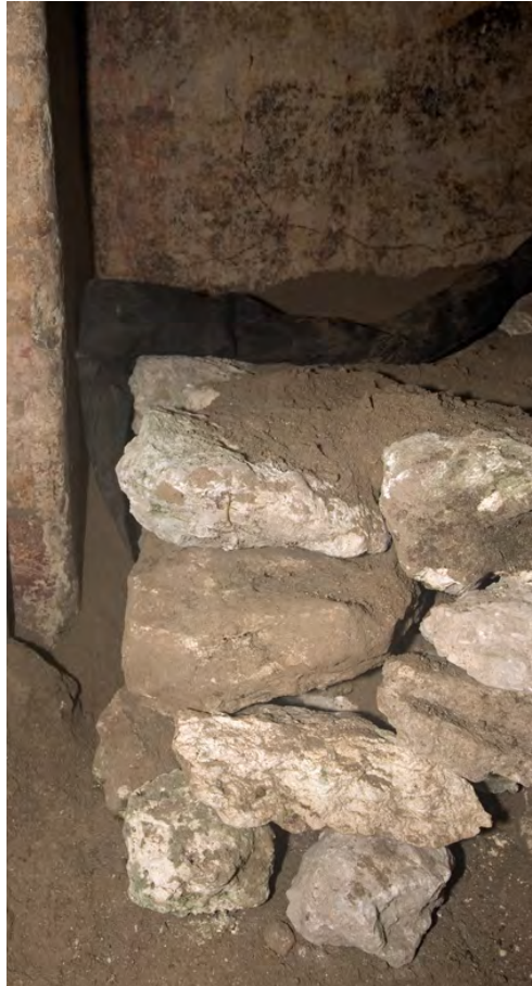
Figura 7.1.9. Muro de contención, geotextil y tierra compacta para proteger la pintura mural, Estructura 10K2, Xultun. (Fotografía: B. Beltrán, 2014).
