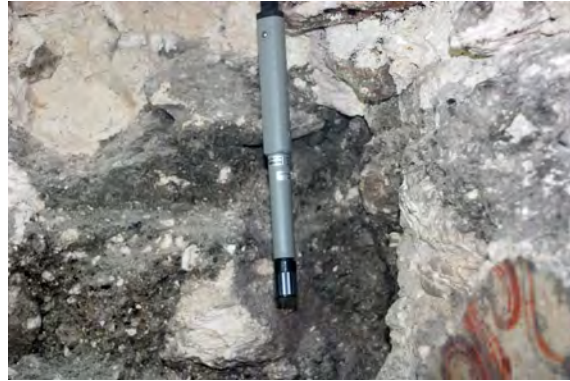
Figura 8.1.8. Estación 1. Sensor de Humedad en el interior del Cuarto de los Murales
