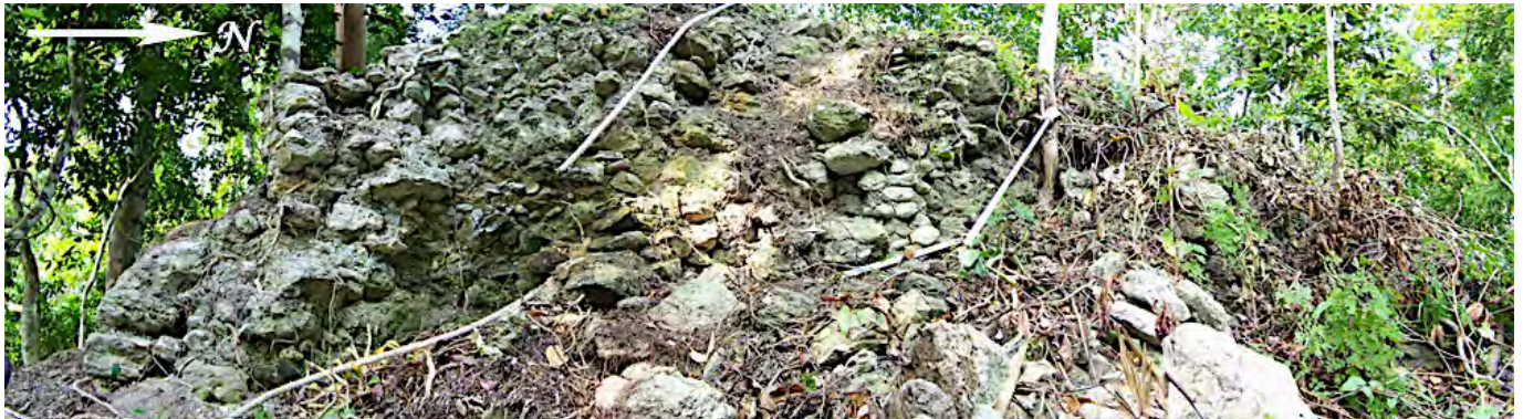
Figura 2.1.4. Cima destruida de la fachada este de la Estructura 11J9 (Fotografía: L. Velásquez, 2014).
