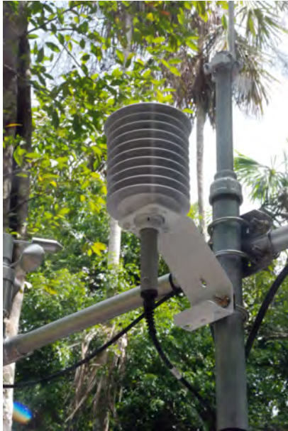
Figura 8.1.15. Sensor de Humedad, Estación 2.
