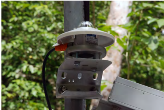
Figura 8.1.13. Medidor Pluvial de la Estación 2.
