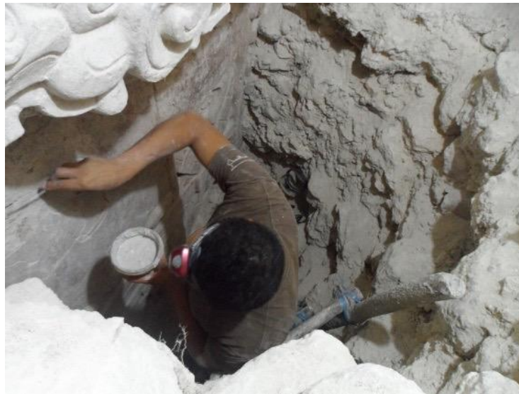
Figura 6.8. Trabajo de consolidación, en excavación lado norte bajo el mascarón del Dios Chaak (Fotografía por Edwin Pérez Robles).
