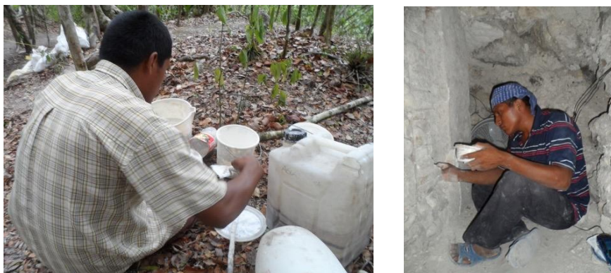
Figura 6.4 y 6.5. Héctor Cervantes aplicando la mezcla de consolidación, quien también realizó trabajo diario de aspersión de lejía el estuco y efectuando la mezcla de cal, el contacto directo con los materiales y la familiarización con las proporciones requeridas, ayuda a mejorar el aprendizaje (Fotografía por Edwin Pérez Robles).
