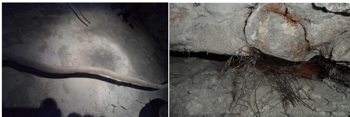
Figura 6.1 y 6.2. Ejemplos de raíces expuestas: los mascarones presentan fisuras internas no expuestas en donde se alojan raíces en la parte posterior, creciendo entre el muro y el estuco, provocando desprendimientos de secciones completas de los mascarones. Es necesaria la eliminación de las mismas, ya que han atendido sólo cuando se abren paso a través de las grietas y fisuras (Fotografía por Edwin Pérez Robles).
