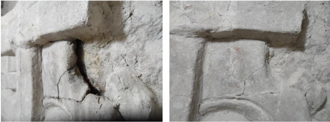
Fotos 8.18 y 8.19. Oquedad y grietas causadas por raíz, la pieza fue resanada consolidándose las fisuras (Fotos, E. Pérez 2018).
