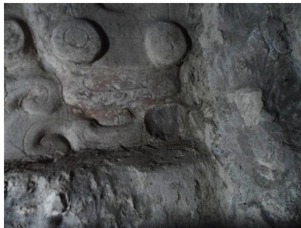
Figura 8.46. Área de estuco en mejores condiciones, se resanaron fisuras y grietas, y en las oquedades todos los bordes del faltante. (Foto: E. Pérez, 2018).
