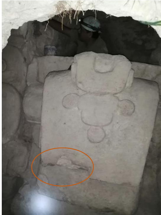
Figura 5.13. Área a realizar un resane por pérdida de estuco, para este proceso es necesario contar con el apoyo de varillas para ejercer presión constante en las partes resanadas (H. Cervantes, 2021).
