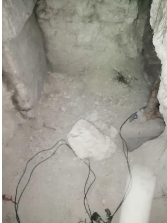
Figura 5.7. Roca de tamaño considerable de colapso, túnel lado norte (E. Pérez, 2021).
