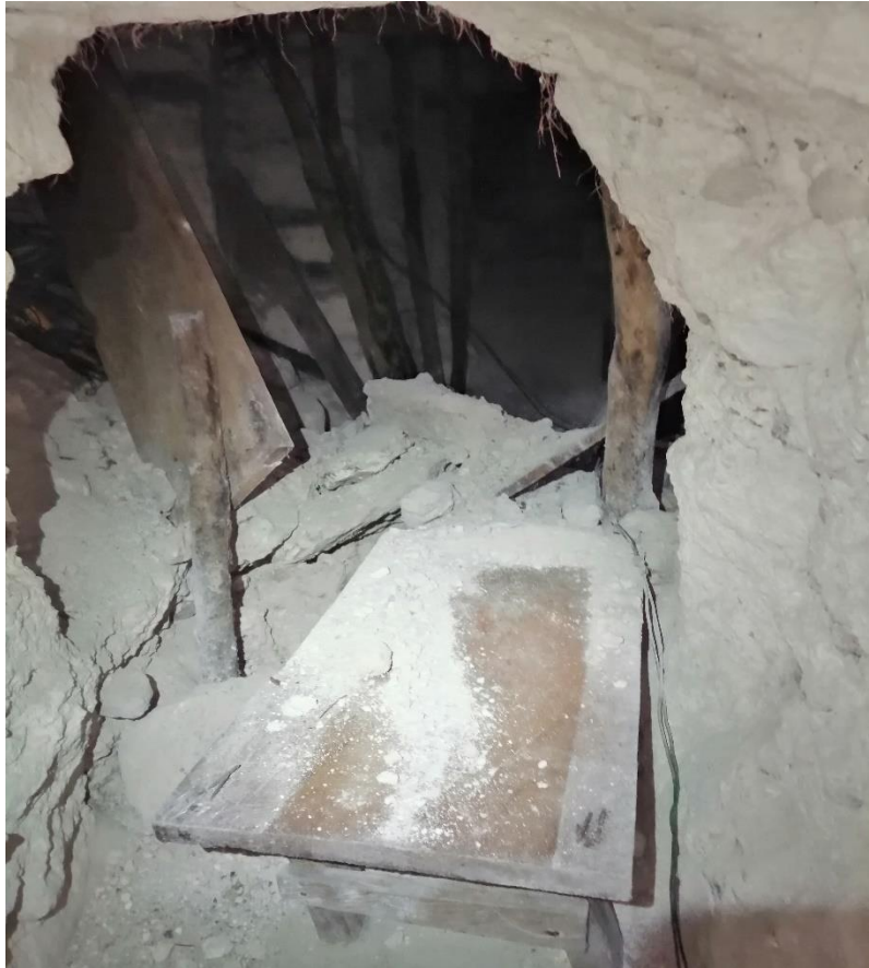
Figura 5.1. Colapso túnel de ingreso del Templo del Sol Nocturno, Grupo el Diablo, debido al debilitamiento de los parales a causa de la humedad en el interior del túnel (E. Pérez, 2021).
