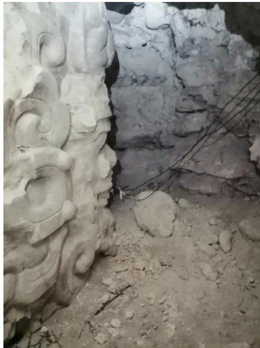
Figura 5.6. Piedra que colapso de la parte superior del túnel y provoco fracturas, fisuras, disgregación y desprendimiento de resanes en el mascarón de la esquina noreste (E. Pérez, 2021)
