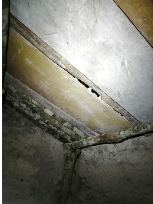
Figura 5.11. Área de colapso ya con puntales de madera de mayor dureza, los tablonces de cedro se encuentran en buenas condiciones por lo que no fue necesario su remplazo colapso de túnel reparado (E. Pérez, 2021).
